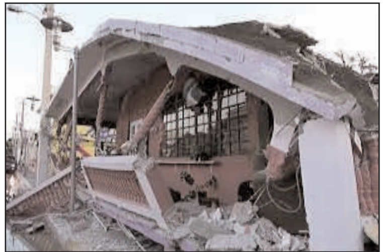
La destruction partout à Porto Rico.
