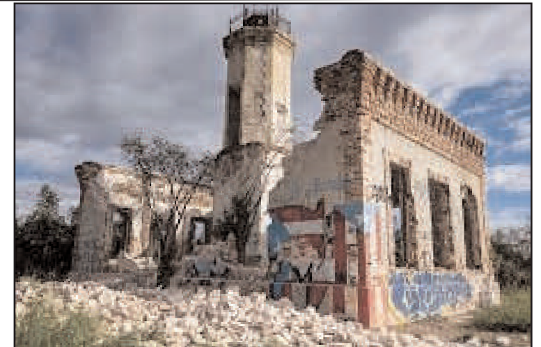
Un immeuble détruit par le tremblement de terre à Porto Rico.
